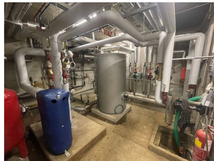
La sous station de l'Ehpad
